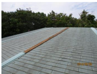
(剥離した緑の相談所の屋根材)
